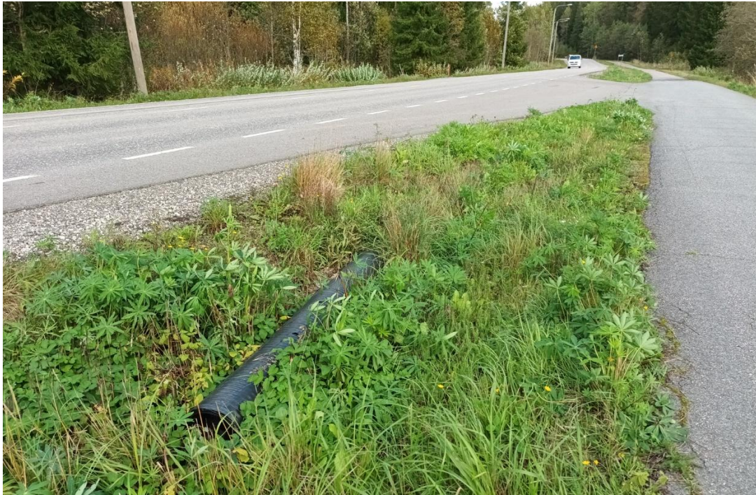
Kuva 17. Nostavantien kuivatus perustuu nykyisellään reunaajiin, painanteisiin ja mataliin rumpuihin. [Ramboll 17.9.2025]
